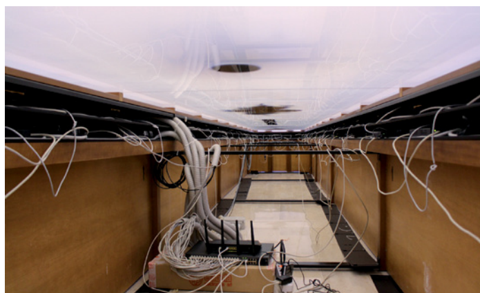
Sotto le postazioni, attraverso una botola, si accede all'interno dell'immenso tavolo della Sala Meeting, dove sono posizionati i daisyNET e i cavi di collegamento delle postazioni.
